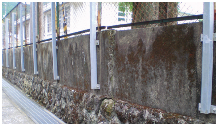
亀裂の入った塀
