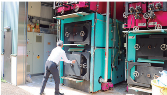
木質バイオマスボイラー（上勝町）
