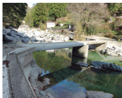
たびたび損傷する大王橋
