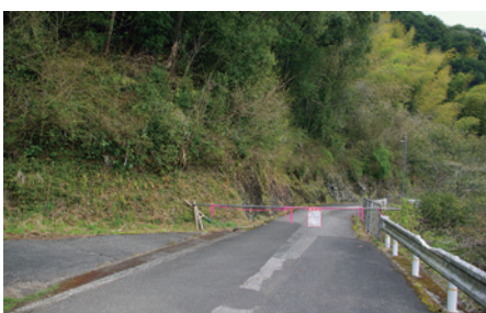
落石の危険があり、長期にわたり通行止めとなっている
