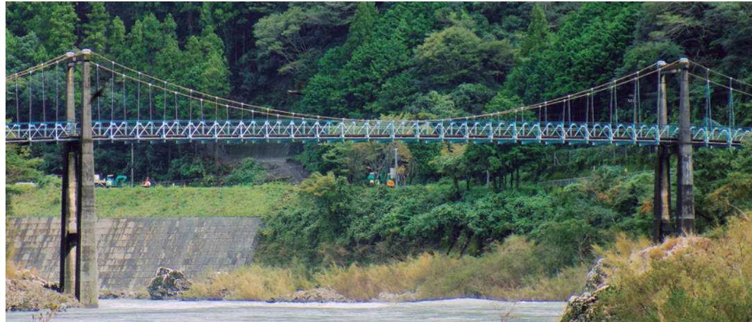
早期改修が望まれる大崎橋
