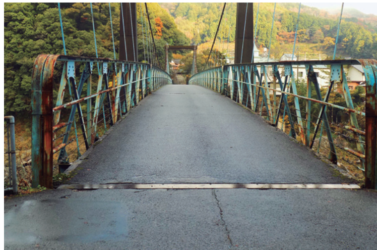
架け替えが急がれる大崎橋
