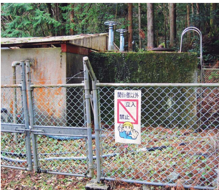
坂本配水区の水源地タンク
