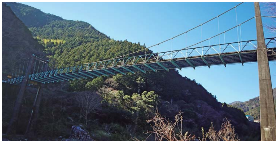
老朽化した大崎橋
