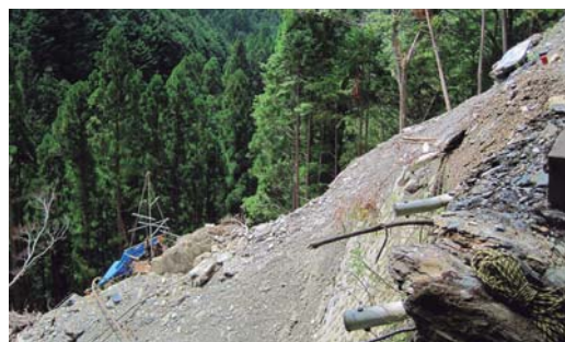
瓜生野土砂崩れ現場
