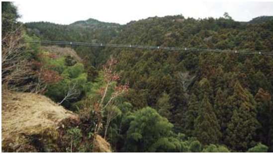
空中を経由する坂本配水区送水管
