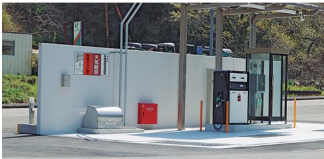
消防自家用給油所
