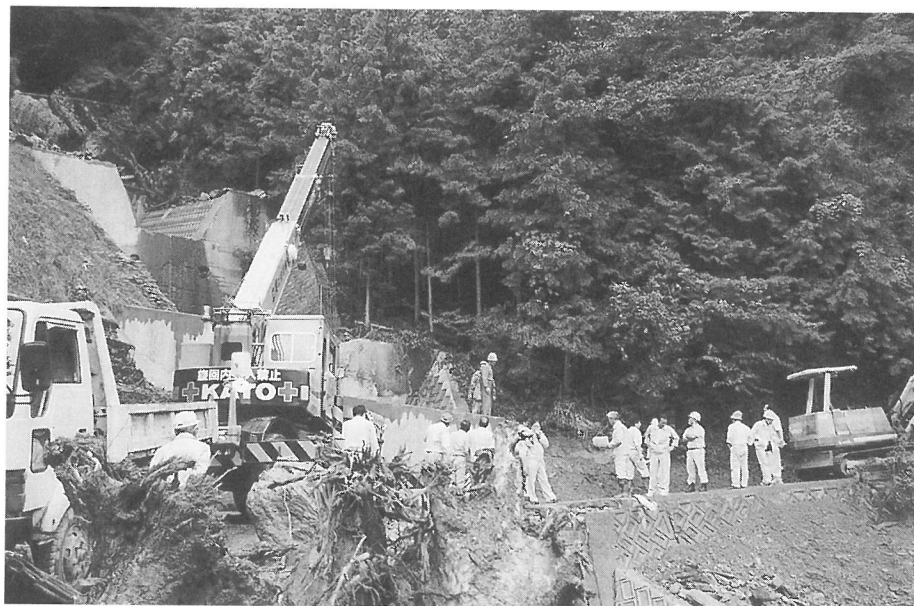
台風災害調査 (池川・椿山)
