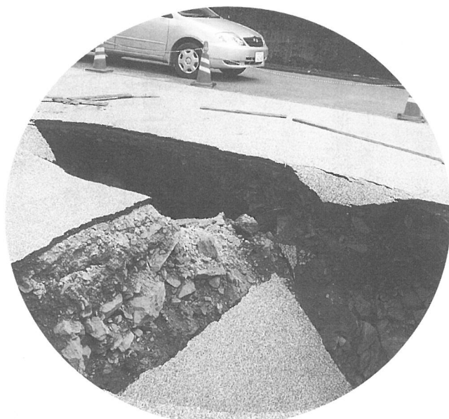
中予電器(株)前の陥没現場（原石山）
