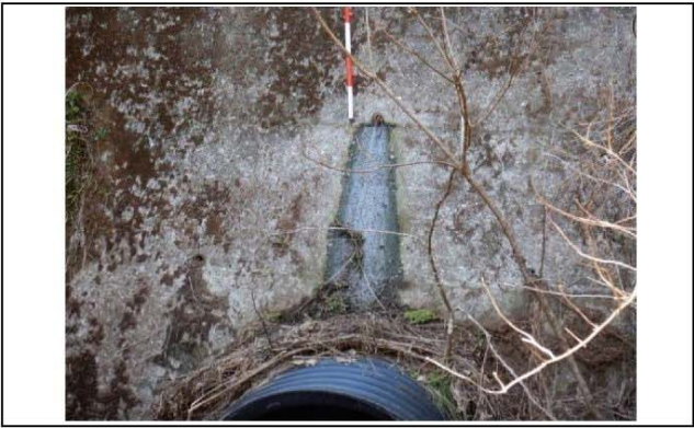
写真3 擁壁工の水抜き穴からは、恒常的な出水がみられる
