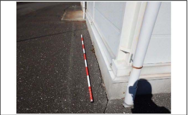
写真20 盛土の沈下により、工場と舗装面の間に発生した隙間と開口亀裂(最大幅2~3cm程度)
