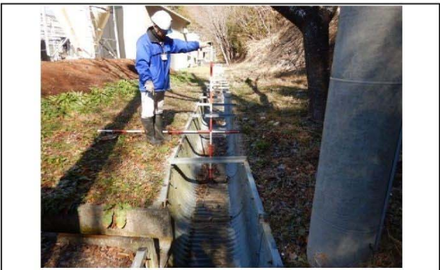
写真11 造成地東縁を流下するU字コルゲート排水路(幅0.8m、深さ0.8m)
