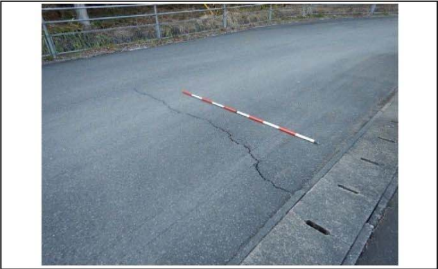
写真18 町営住宅西側の舗装面に発生した開口亀裂(開口幅1~2cm)
