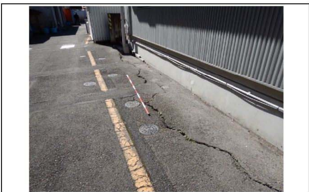
写真14 食品加工場の東側に、開口亀裂と建物側への地盤沈下が見られる
