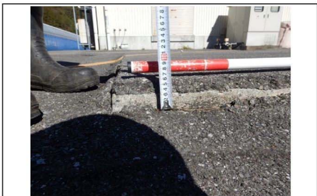
写真13 浄化槽周辺の沈下状況(6cm程度)
