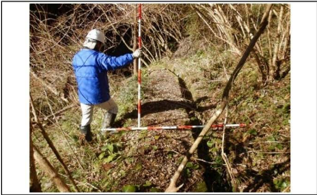
写真6 のり面小段(幅1.5m、張りコンクリートあり)(小段排水工が設置されているが、部分的に土砂で閉塞)
