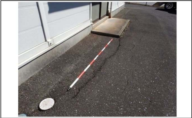
写真21 舗装面の間に発生した開口亀裂(最大幅1.5~2cm程度)
