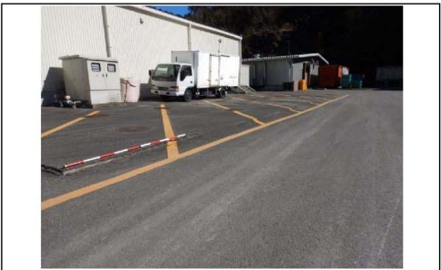
写真12 浄化槽の周囲に、舗装面の沈下と開口亀裂がみられる。浄化槽施工時の盛土の沈下と、輪荷重によるものと考えられる
