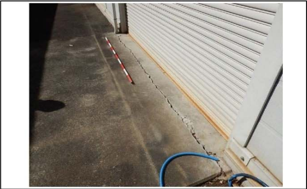
写真22 工場の土間コンクリートと舗装との境界に発生した開口亀裂(開口幅2~3cm程度)
