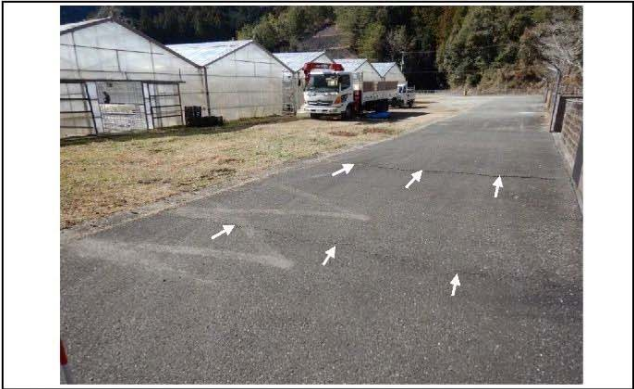
写真17 住宅地前の舗装面に発生した開口亀裂
