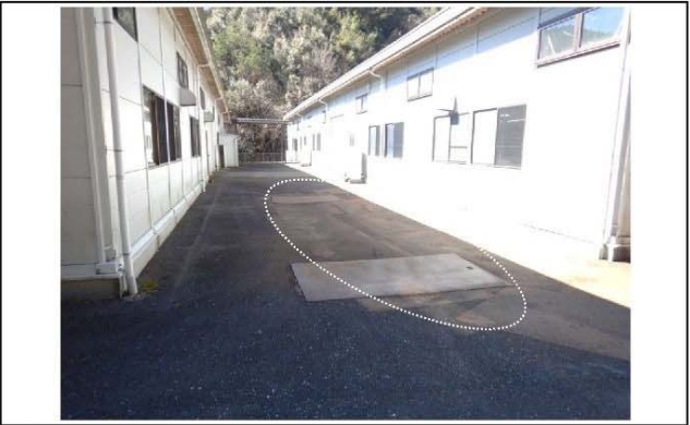
写真23 工場間の地盤面に発生した沈下
