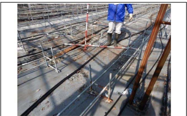
写真16 ビニールハウス内の地盤沈下(直径2~3m、深さ10~15cm程度)
