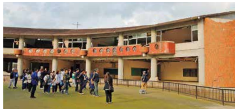
2階天井に津波の跡が残る校舎
