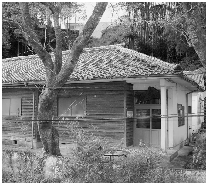
雨漏りがひどくなった「郷土館いけがわ」(土居)
