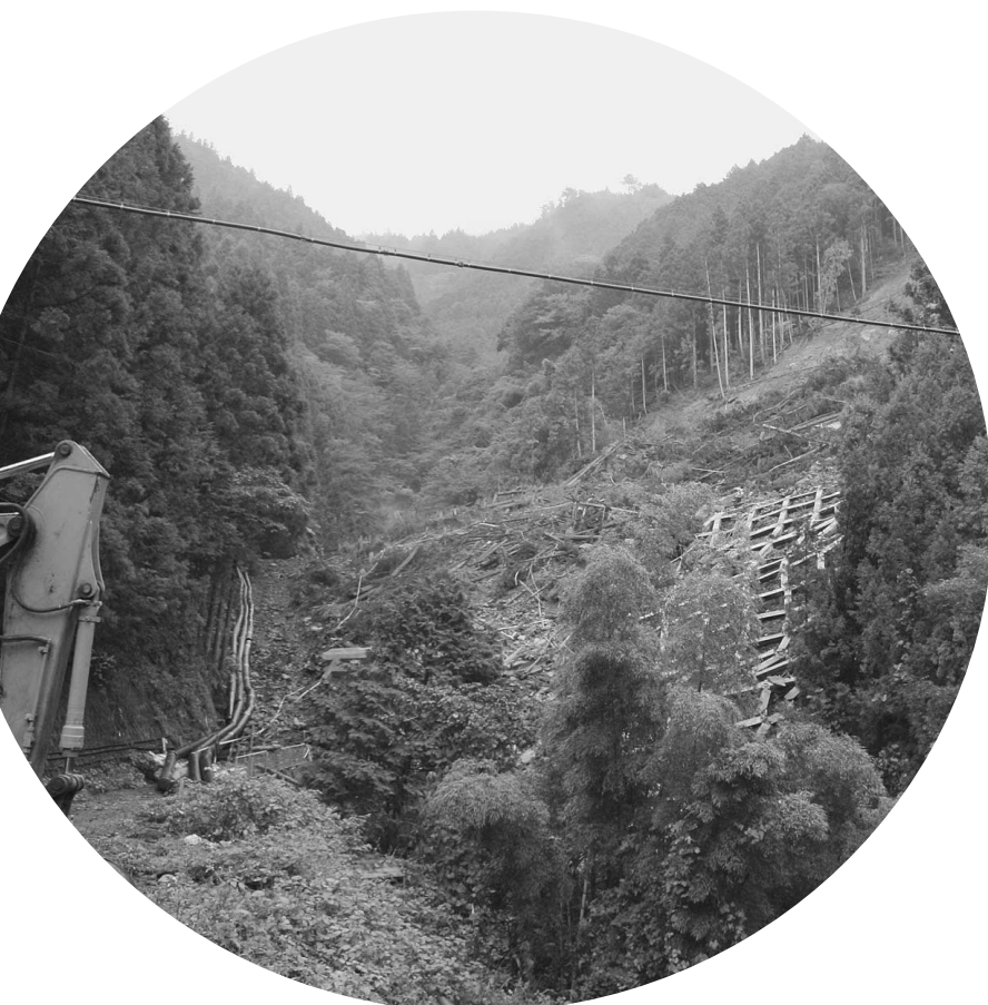
平成18年7月から実に3回目の崩落 今回の工事完成は未定(峯岩戸)
