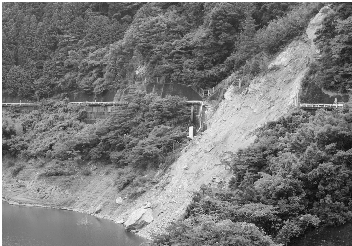
幅70mの地滑りが発生した高瀬線(高瀬)
