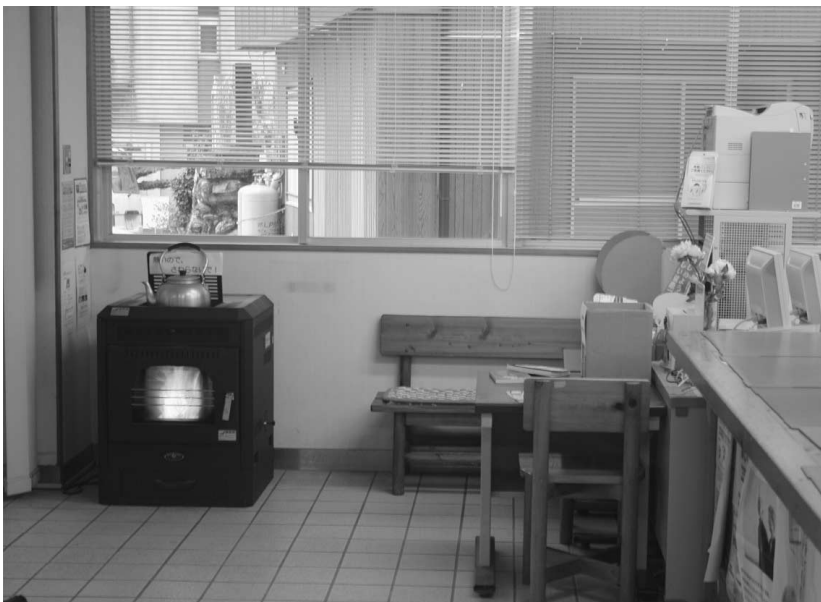
ペレットストーブ。本庁に試験的に設置しているが評判は良い(本庁 住民課)
