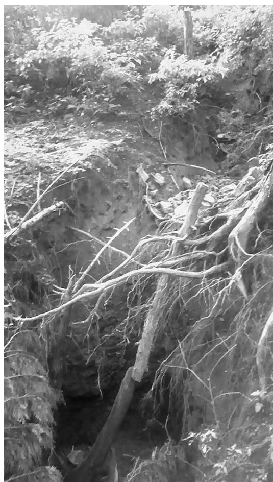
道路排水（危険）
