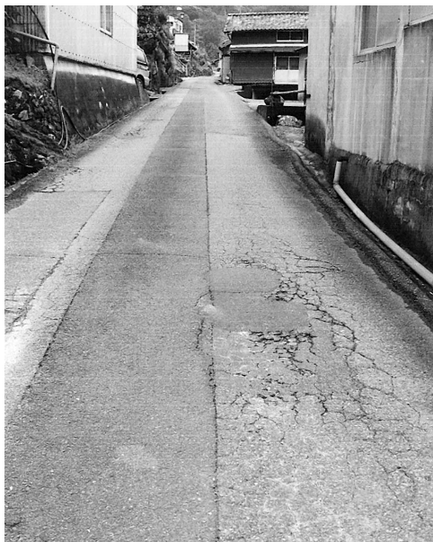
亀裂の多い長者地区
