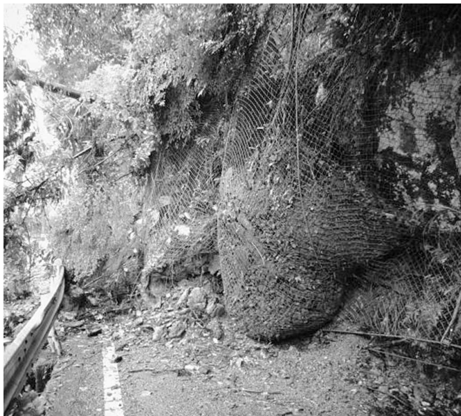
台風11号、12号による崩落現場
