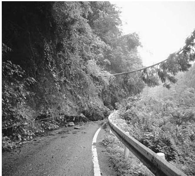
大西の崩落現場
