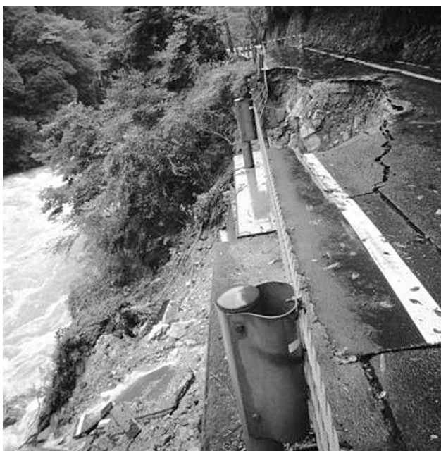
入江谷崩落現場
