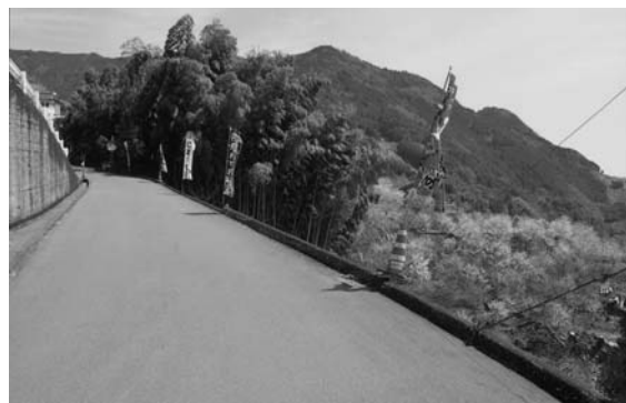
外観的にも危険箇所（町道寺村峯岩戸線）
