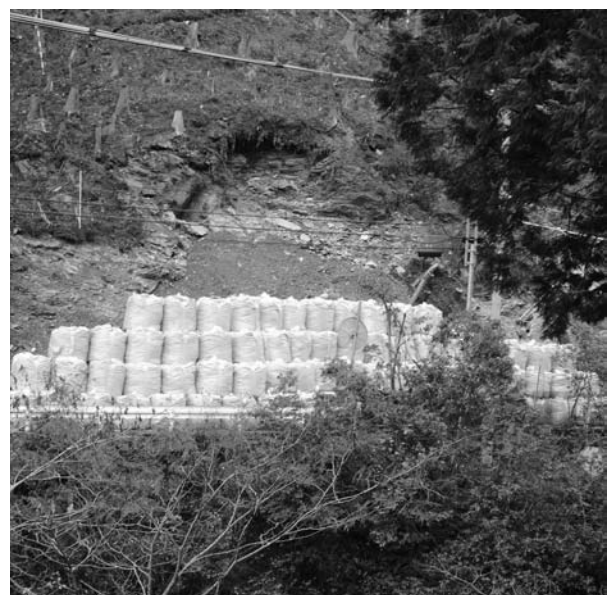
494号の崖崩れ（崩落状況）
