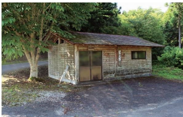
老朽化した星ヶ窪トイレ
