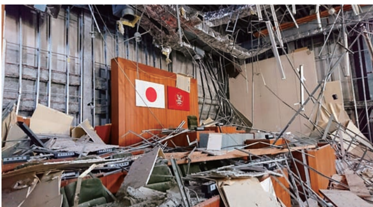
震度7の揺れを2回受けた益城町議会議場
