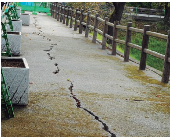
熊本地震の被害状況
